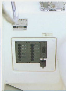
⑦ スイッチパネル、配電盤
