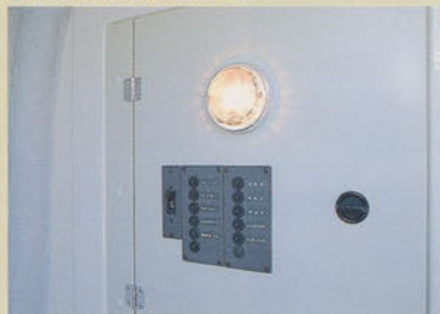
⑨ パワース室内灯・ブレーカーパネル
