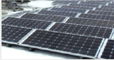
Solar power – 792 kw (USA)
